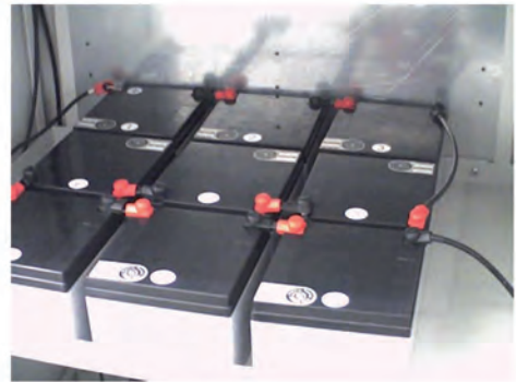
Augenscheinlich intakter Batterieblock
